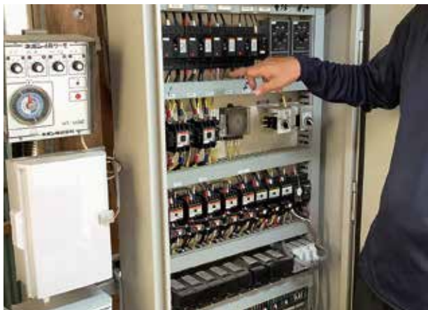
機械で温度や換気の調節を行なっています
