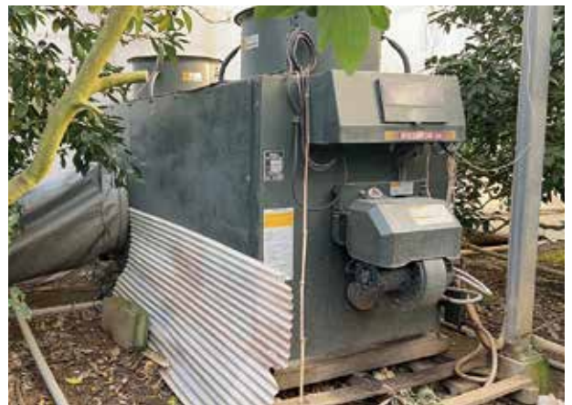
油を焚くボイラー
