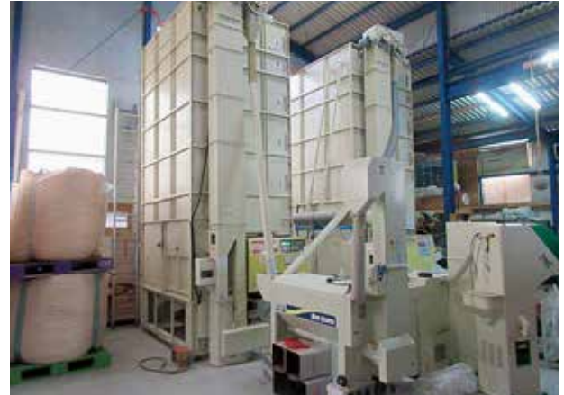
乾燥機や冷媒器など大型の機械が揃っています
